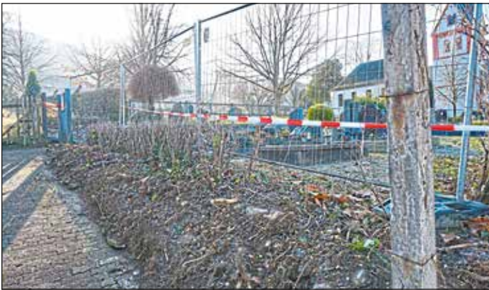
Der Zuweg zum Layer Friedhof von der Untermarkstraße wird saniert und kann etwa drei Wochen lang nicht genutzt werden.
