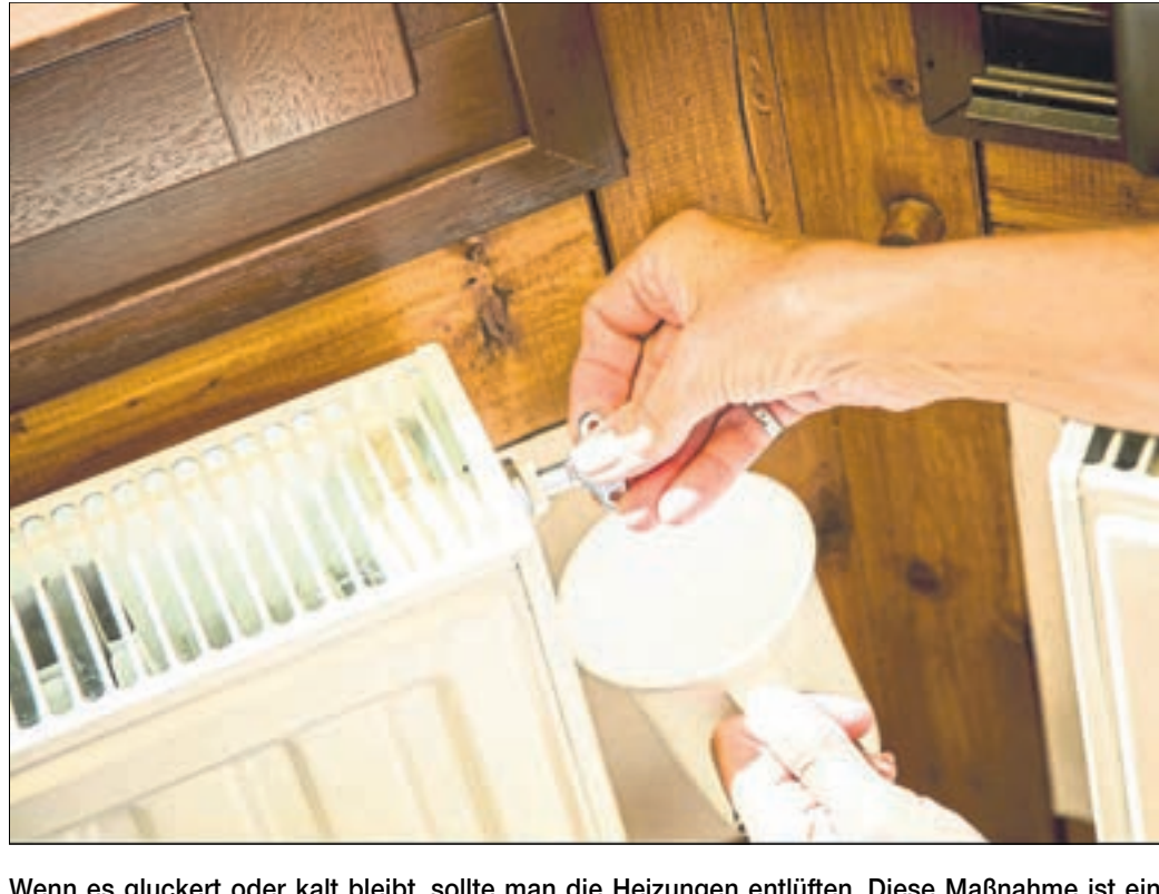
Wenn es gluckert oder kalt bleibt, sollte man die Heizungen entlüften. Diese Maßnahme ist einfach und schnell erledigt, sofern der Heizkörper über ein Entlüftungsventil verfügt. Foto: Christin Klose/dpa-mag
