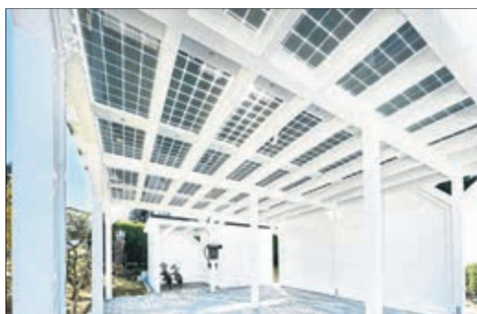
Parkplatz und Elektrotankstelle in einem: Das Solarcarport gewinnt umweltfreundliche Energie, die direkt im Haushalt oder für das E-Autos verwendet werden kann. Foto: djd/www.solarcarporte.de
