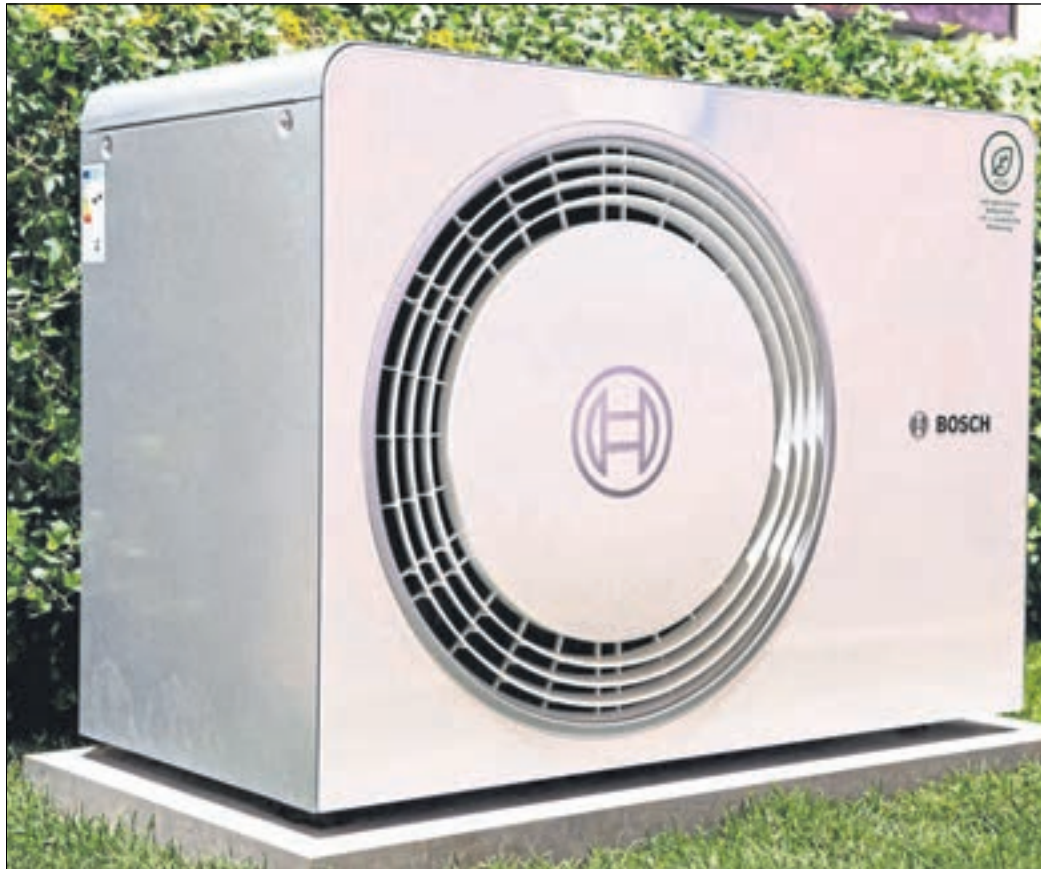
Käfig oder Umzäunung Fehlanzeige: Zur Sicherung vor Diebstahl sollte eine Wärmepumpe zumindest fest mit dem Fundament verschraubt sein.
